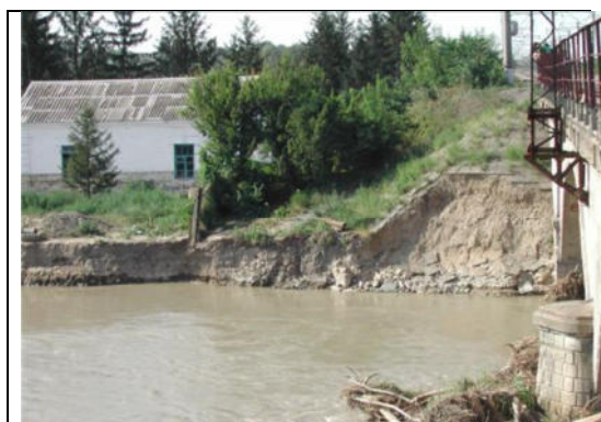
Подмыв конуса моста
